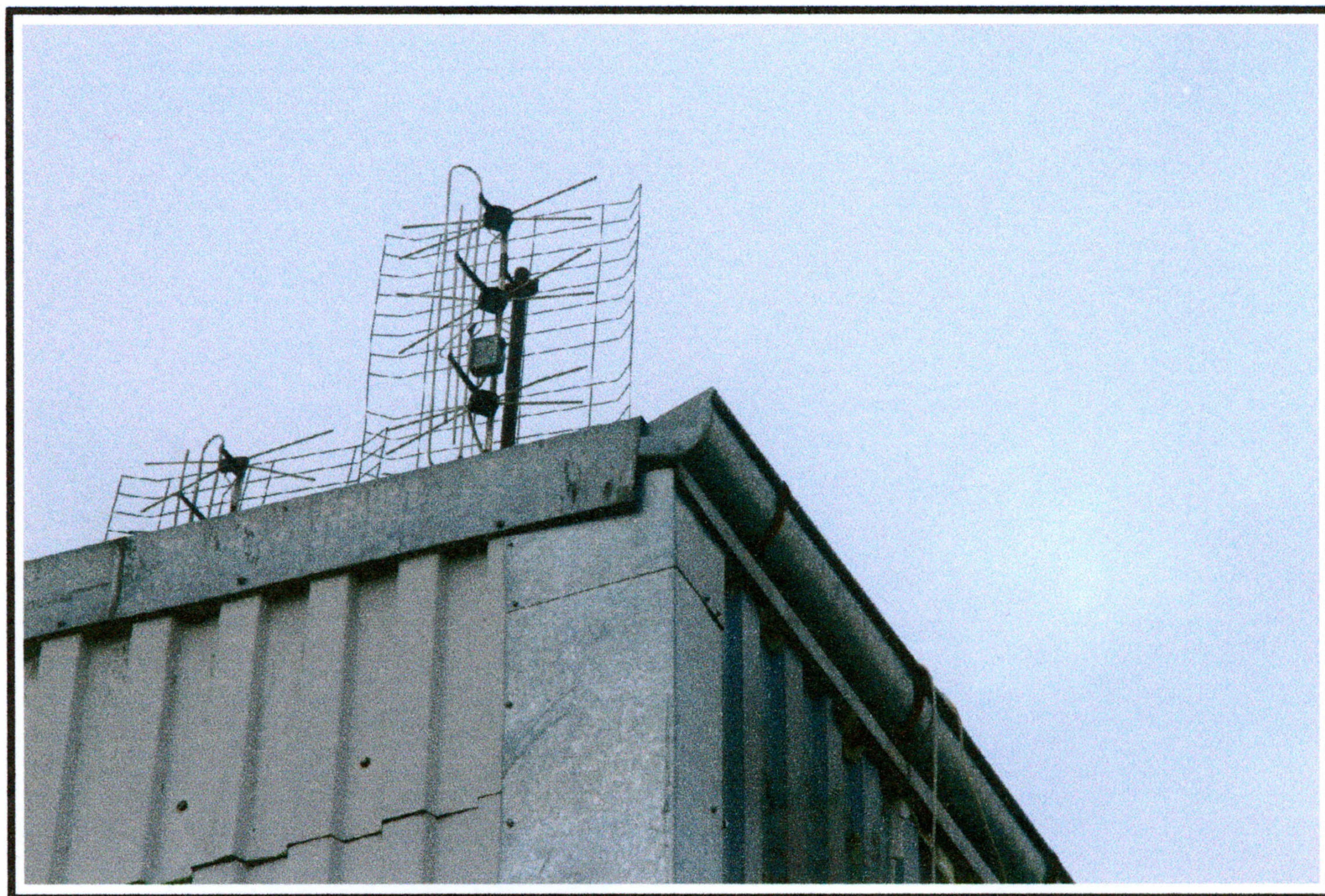
Elewacja południowo - wschodnia, niewłaściwy sposób ułożenia rynny..
