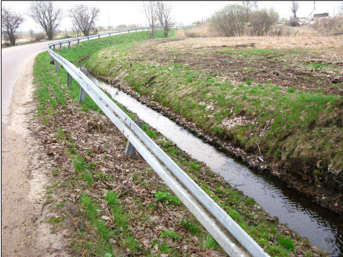
Fot. 4. Bariera ochronna po prawej stronie drogi, widok w kierunku DP 1578N
