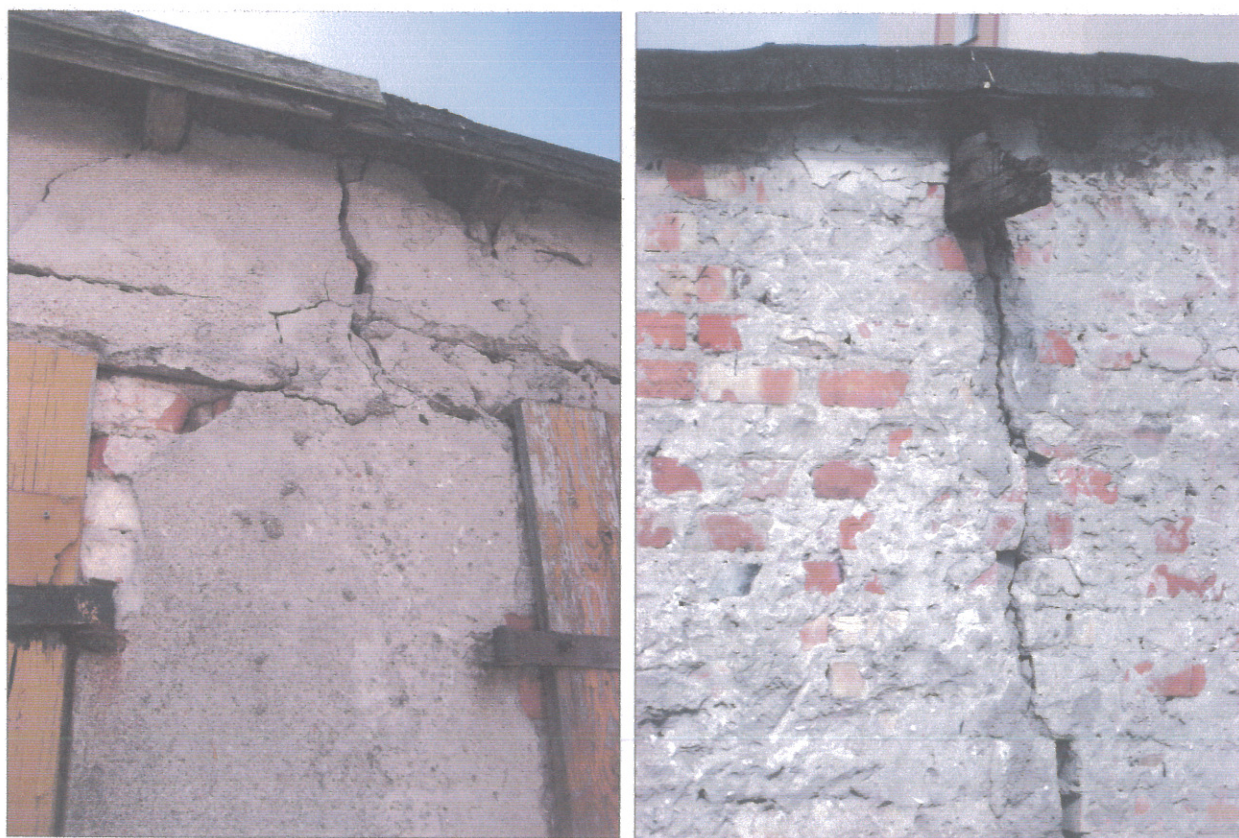
Fot. Nr 5 Budynek nr 1 – spękania ścian
