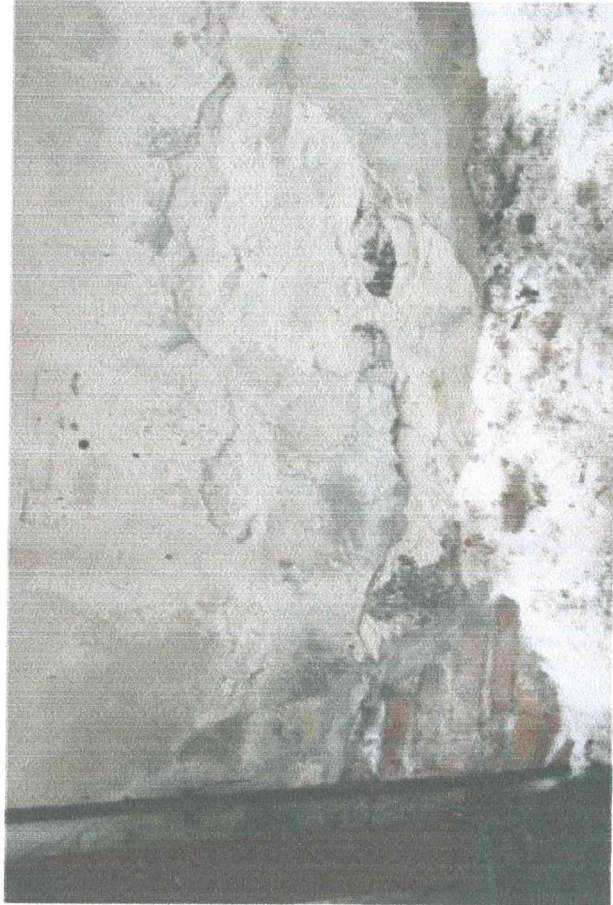
fol. 15 Stan tynków w partii przyziemia, elewacja zachodnia zabudowań podzamcza.
