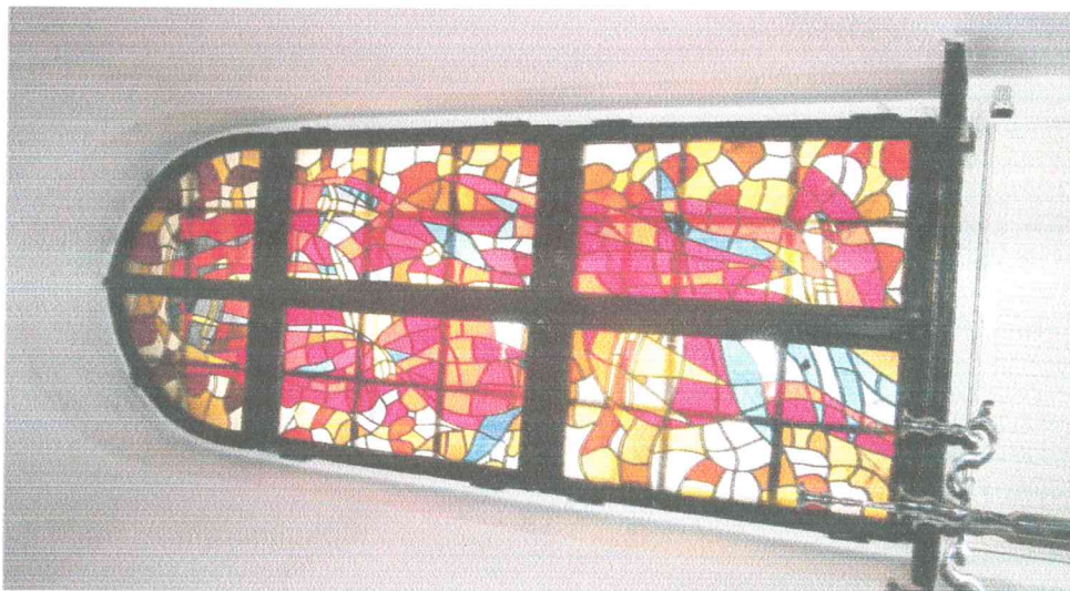
foto. 45 Widoczny rewers okna Sali Rycerskiej ze szkleniem witrażowym pochodzące z 3 ćw. XX wieku, stan obecny. Okna wykonano w konstrukcji drewnianej, zespolone, od strony wewnętrznej występuje szklenie witrażowe na ramkę otwiorową, od strony zewnętrznej skrzydła dzielone za pomocą krzyżowych szczebli konstrukcyjnych, szklenie zwykłym na kit szklarski. Drewno malowane jest kryjąco na kolor brunatny.
