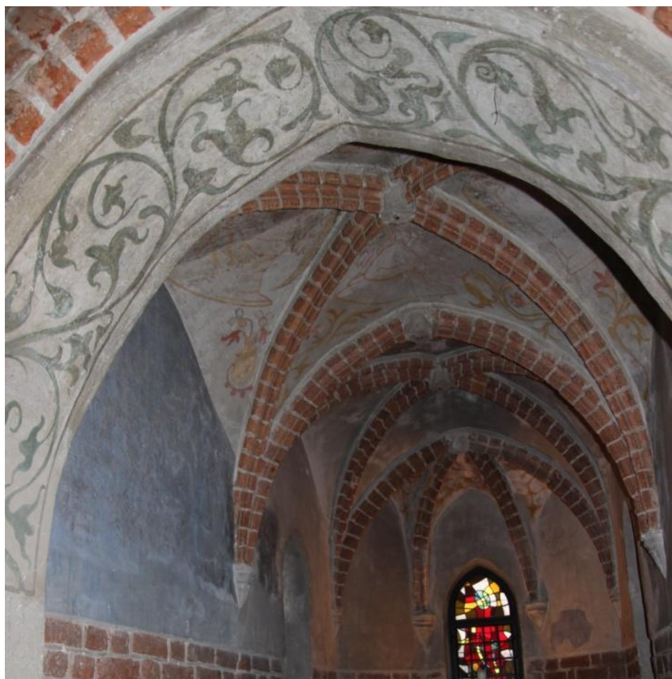
fot. 3. Widok kaplicy od strony północnej. Na pierwszym planie widoczne malarstwo w partii łuku sklepiennego.
