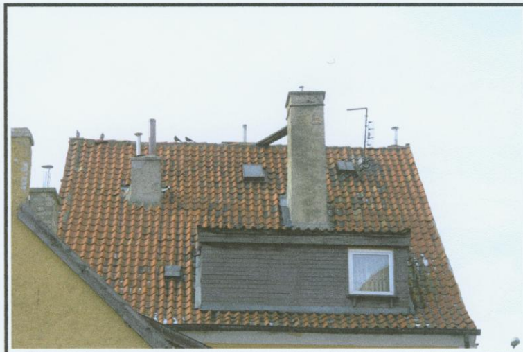
Lukarna od strony podwórza, widoczne skorodowane cegły kominów.
