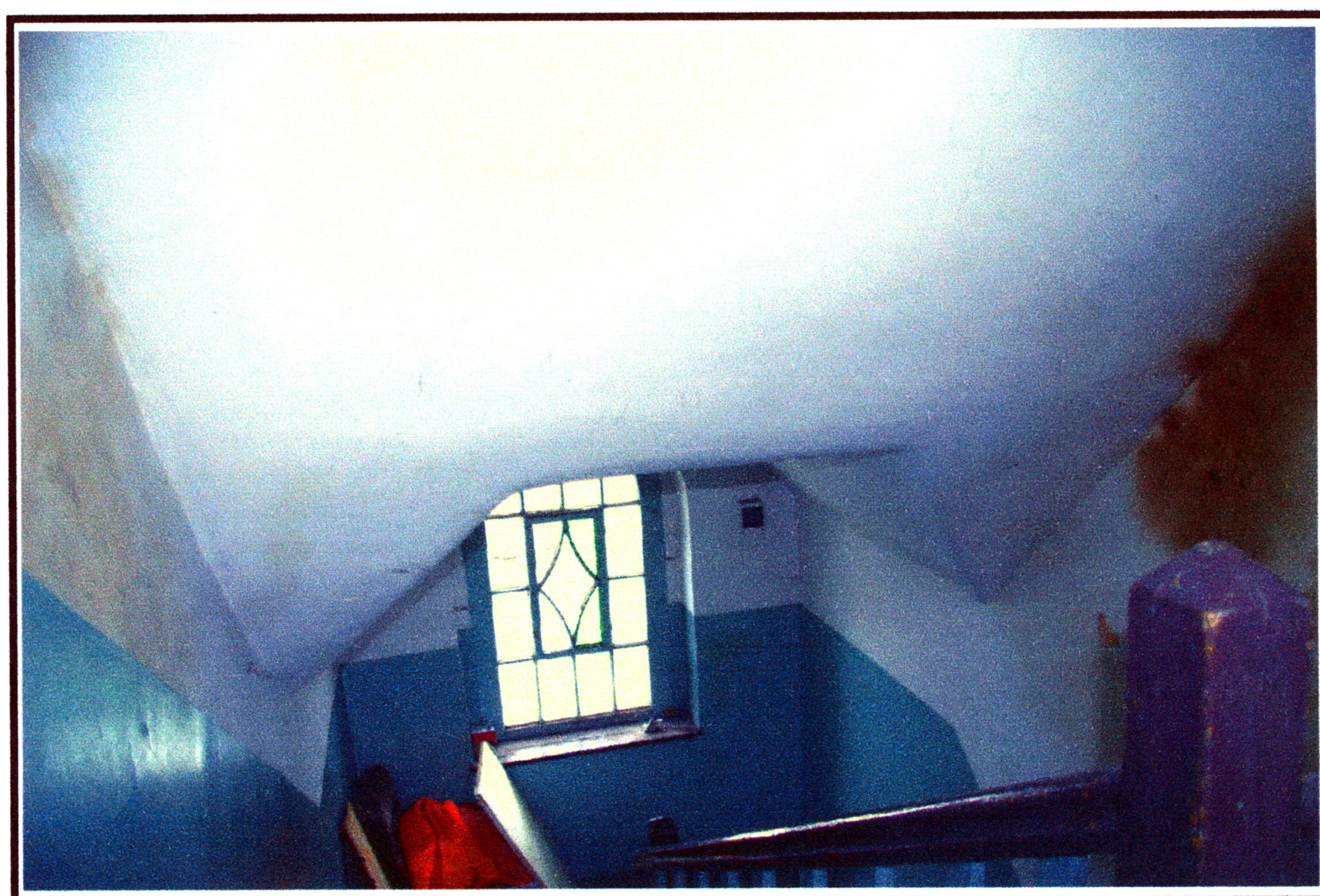
Widok na klatkę schodową widoczne zacieki na kominie.
